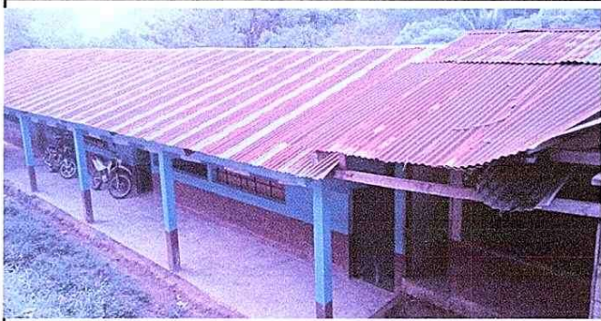
Se observa el deterioro del entechado y el corredor del establecimiento.
