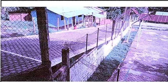
Se ve el daño que tiene la malla perimetral y lo vulnerable que se encuentra el establecimiento.
